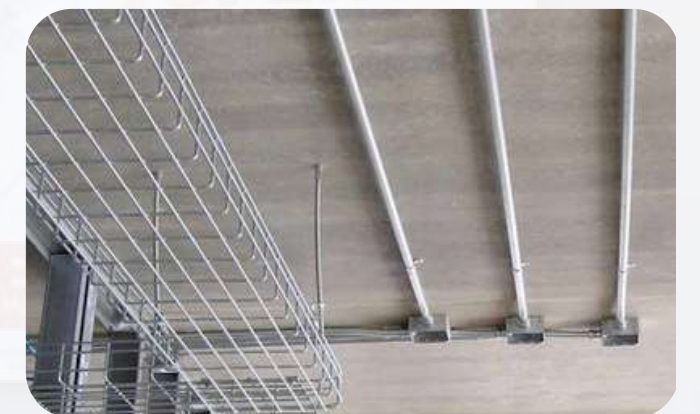
Soporte y canalización
