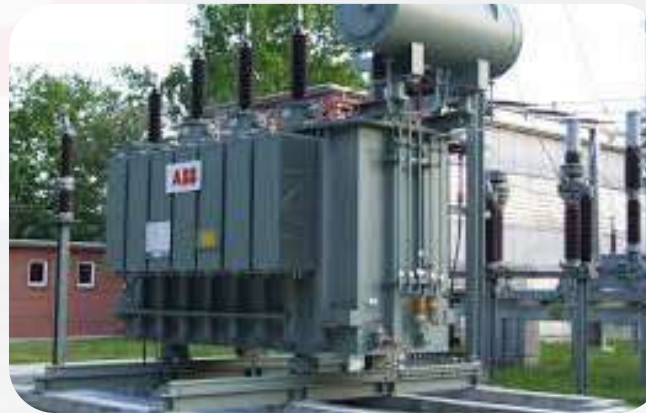
Transformadores y Subestaciones
