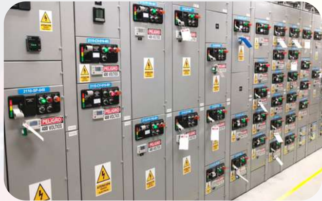
Equipo de control y distribución
