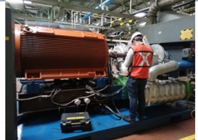
Alineación laser de compresor
