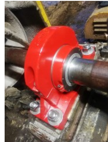
Instalación chumaceras CRAFT
